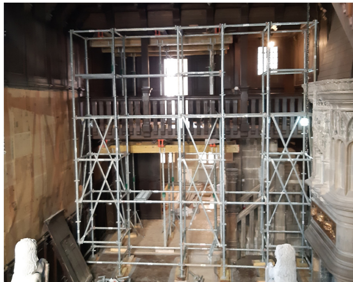
Installation de chantier pour la restauration du plafond de la salle renaissance
